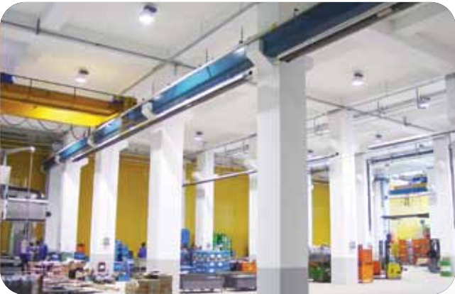
Fabrika Uygulaması: Düz Tip Üniter Sistem – Genel Isıtma
