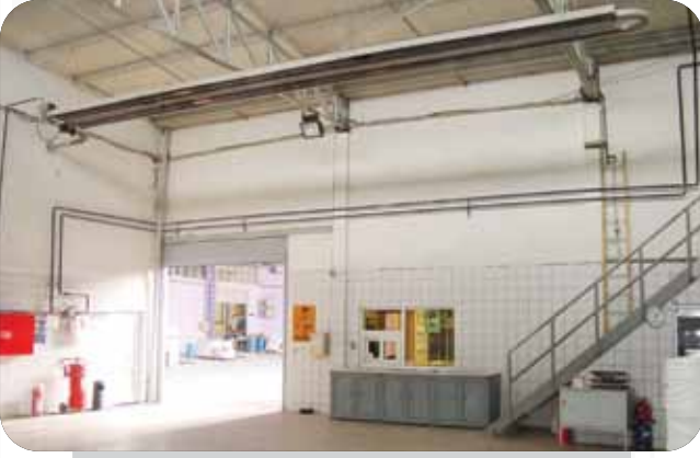
Fabrika Uygulaması: U Tip Üniter Sistem - Lokal Isıtma
