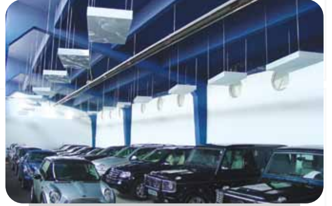
Showroom Uygulaması: Seri Yakıclı Sistem - Genel Isıtma
