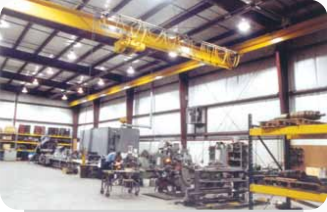
Fabrika Uygulaması: Seri Yakıclı Sistem - Genel Isıtma
