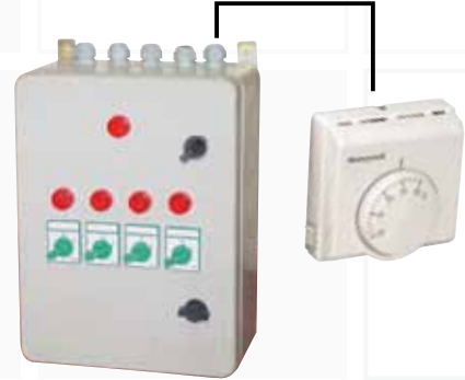
Hava Termostatlı Kontrol Panosu
