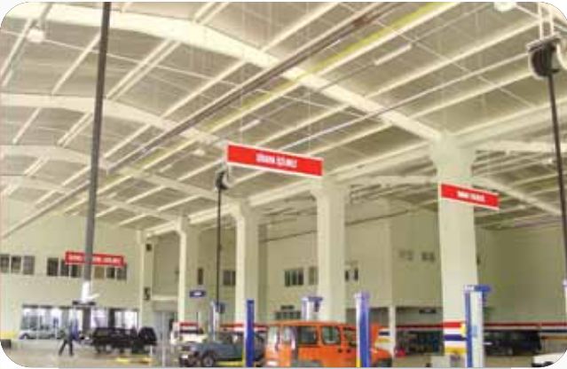
Oto Servis Uygulaması: Düz Tip Üniter Sistem - Genel Isıtma
