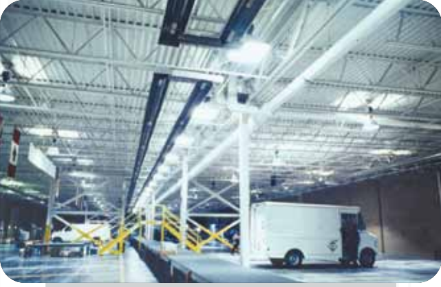
Depo Uygulaması: Seri Yakıclı Sistem - Genel Isıtma
