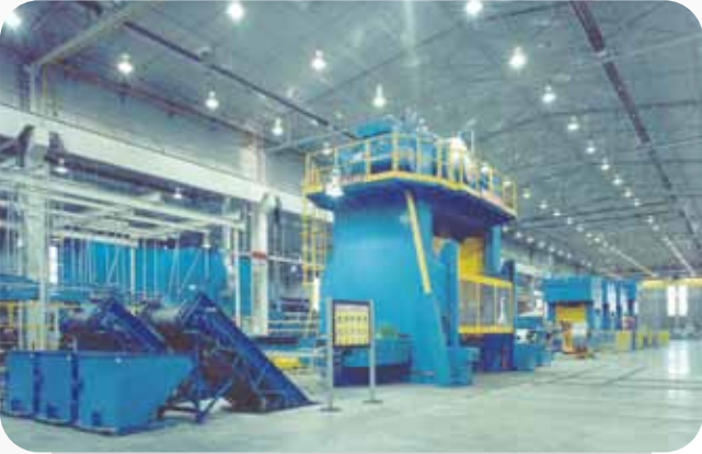
Fabrika Uygulaması: Seri Yakıclı Sistem - Genel Isıtma
